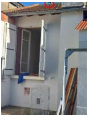
Photo n° PhA010 Localisation : Parties extérieures Ouvrage : 4. Eléments extérieurs - Conduits en toiture et façade Partie d'ouvrage : Conduits de fumée en amiante-ciment Description : Conduits de fumée en amiante-ciment Localisation sur croquis : M002
