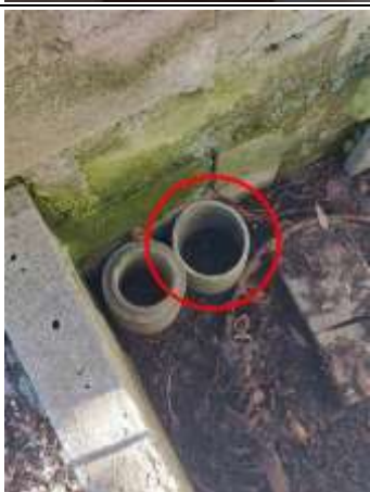
Photo n° PhA009 Localisation : Parties extérieures Ouvrage : 3. Conduits, canalisations et équipements intérieurs - Conduits de fluides (air, eau, autres fluides) Partie d'ouvrage : Conduits Description : Conduits
