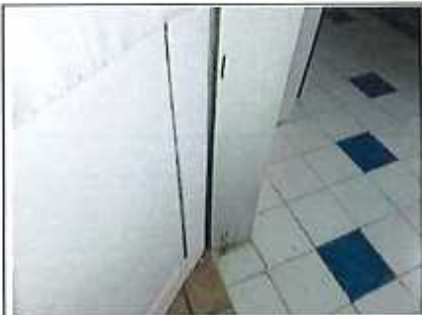
Photo n° PhTer001 Localisation : Rez de chaussée - Salle de bain 2 Ouvrage : Boiseries Parasite : Présence d'indices d'infestation de termites, Termites souterrains Indices : altérations dans le bois.
