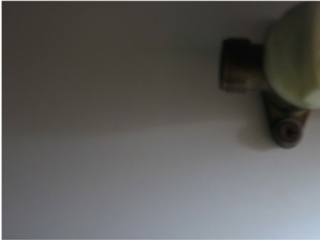
Absence du bouchon vissée RCA – local chaudière- Buanderie
