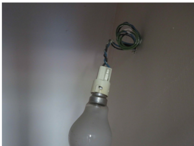
Douille de chantier
