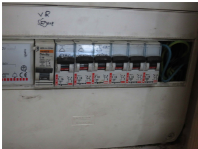
Absence de cache tableau de répartition
