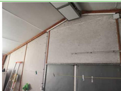
Photo n° PhA002 Localisation : Annexe - lingerie Ouvrage : 3 - Parois verticales intérieures - Cloisons sèches (assemblées, préfabriquées) Partie d'ouvrage : Panneaux de cloisons lisses ou moulurées, préfabriquées ou non Description : Panneaux de cloisons lisses ou moulurées, préfabriquées ou non
