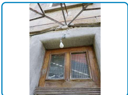
Anomalie B.8.3 e sur Install. n°1
