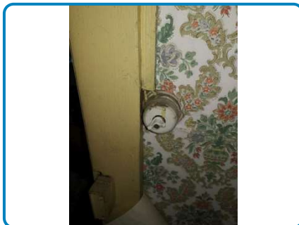
Anomalie B.8.3 a sur Install. n°1
