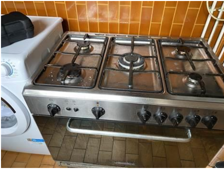
Photo n° PhGaz001 Localisation : Cuisine Cuisinière Inconnue (Type : Non raccordé)
