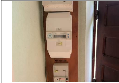
Photo du Compteur électrique
