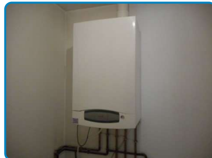
Appareil n°2 (Chaudière mixte) sur installation n°1 (dans Rez de chaussée Cellier)
