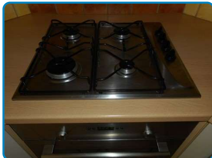
Appareil n°1 (Table de cuisson) sur installation n°1 (dans Rez de chaussée Séjour coin cuisine)
