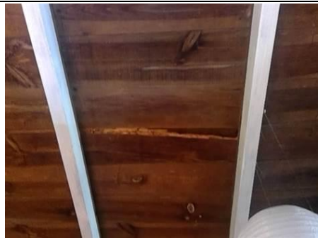
Photo n° PhTer002 Localisation : RdC - Salle Ouvrage : Plafond - Bois et Toile Parasite : Présence d'indices d'infestation de termites, Termites souterrains Indices : altérations dans le bois
