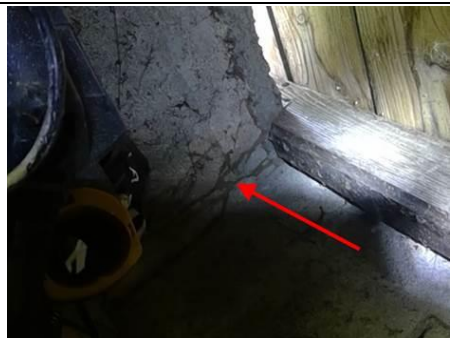
Photo n° PhTer003 Localisation : Extérieur - Abri 1 Ouvrage : Murs - Parpaings Parasite : Présence d'indices d'infestation de termites, Termites souterrains Indices : galeries-tunnels (cordonnets)
