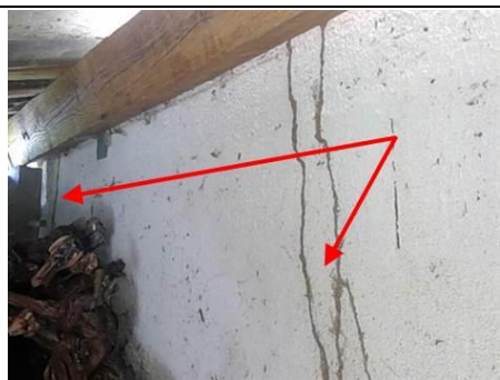
Photo n° PhTer001 Localisation : Extérieur - Abri bois 2 Ouvrage : Murs - Parpaings -Bois Parasite : Présence d'indices d'infestation de termites, Termites souterrains Indices : galeries-tunnels (cordonnets)
