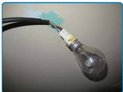
Anomalie B.8.3 b sur Install. n°1
