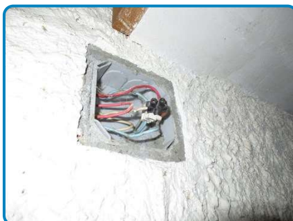
Anomalie B.7.3 d sur Install. n°1
