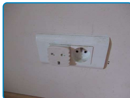
Anomalie B.3.3.6 a2 sur Install. n°1
