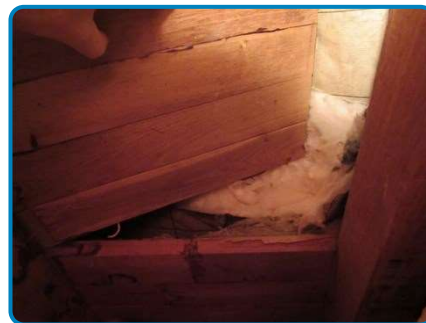
Non accessible accès trop étroit et bloqué par l'isolant, risque de dégradation de l'isolant (Maison principale 2ème étage Combles)
