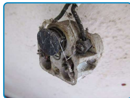
Anomalie B.7.3 c2 sur Install. n°1
