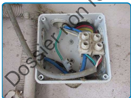
Anomalie B.7.3 d sur Install. n°1 Anomalie B.8.3 e sur Install. n°1
