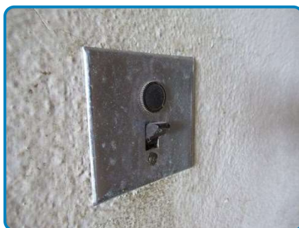
Anomalie B.7.3 e sur Install. n°1
