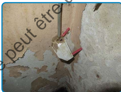
Anomalie B.7.3 a sur Install. n°1
