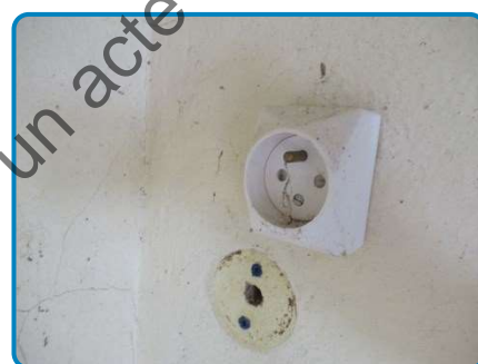
Anomalie B.3.3.6 a2 sur Install. n°1
