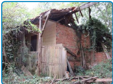
Accès dangereux, plancher bois en cours d'effondrement et végétation envahissante (Maison en ruine Maison en ruine)
