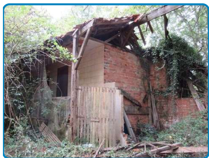
Accès dangereux, plancher bois en cours d'effondrement et végétation envahissante (Maison en ruine Maison en ruine)
