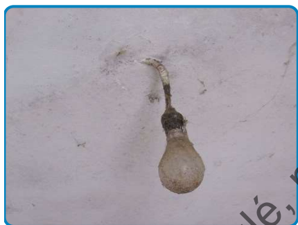
Anomalie B.3.3.6 a3 sur Install. n°1
