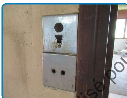
Anomalie B.3.3.6 a1 sur Install. n°1
