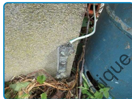
TERRE sur Install. n°1 (dans Maison principale Rez de chaussée Entrée)
