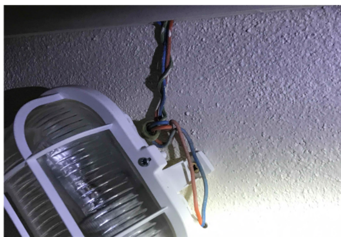
Conducteurs non protégés luminaire toilette
