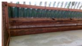
Charpente et couverture (amiante)
