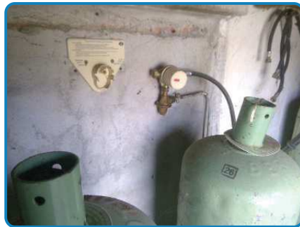
Anomalie 7b (DGI) sur Install.n°1
