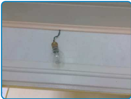
Anomalie B.3.3.6 a3 sur Install. n°1
