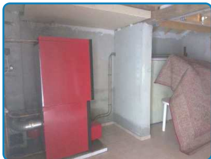
Maison principale Rez de chaussée Chaufferie
