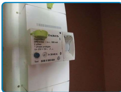
Anomalie B.2.3.1 i sur Install. n°1 (AGCP)
