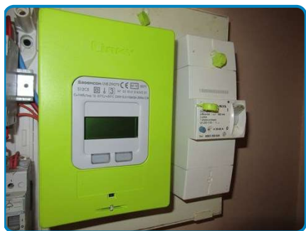
COMPTEUR sur Install. n°1 (dans Rez de chaussée Bureau)
