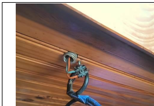
Photo n° PhEle007 Elément présentant des parties actives nues sous tension (domino chambre étage)
