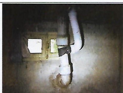
Photo n° PhA001 Localisation : Sous-Sol - Cave Ouvrage : 6 - Conduits et accessoires intérieurs - Conduits de fluides (air, eau, vapeur, fumée, échappement, autres fluides) Partie d'ouvrage : Conduit en fibres-ciment Description : Conduit en fibres-ciment Localisation sur croquis : M001
