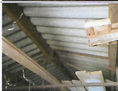
Photo n° PhA002 Localisation : Extérieur - Garage Ouvrage : 1 - Couvertures, Toitures, Terrasses et étanchéités - Plaques ondulées et planes Partie d'ouvrage : Plaques en fibres-ciment (y compris plaques « sous tuiles ») Description : Plaques en fibres-ciment (y compris plaques « sous tuiles ») Localisation sur croquis : M002
