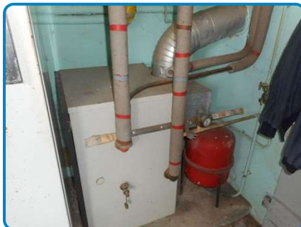
Appareil n°1 (Chaudière chauffage) sur installation n°1 (dans Maison principale Rez de chaussée Arrière cuisine)
