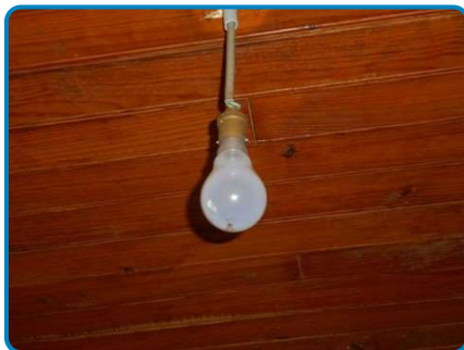
Anomalie B.8.3 a sur Install. n°1
