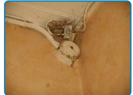
Anomalie B.8.3 a sur Install. n°1
