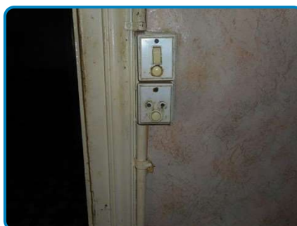
Anomalie B.7.3 e sur Install. n°1
