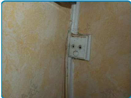
Anomalie B.3.3.6 a1 sur Install. n°1 Anomalie B.8.3 a sur Install. n°1
