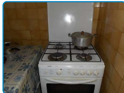
Appareil n°2 (Cuisinière) sur installation n°1 (dans Maison principale Rez de chaussée Cuisine)
