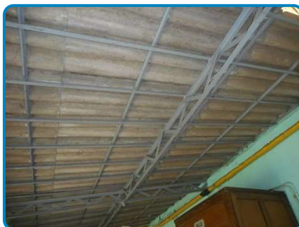
Plafond Plaques fibres ciment (dans Maison principale Rez de chaussée Arrière cuisine)
