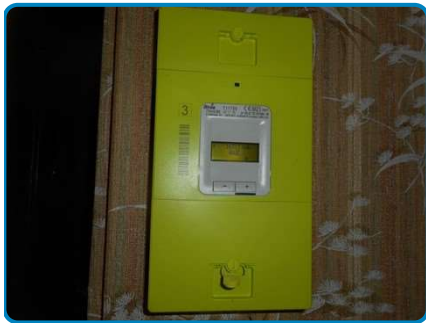
COMPTEUR sur Install. n°1 (dans Maison principale Rez de chaussée Entrée)
