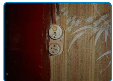
Anomalie B.8.3 a sur Install. n°1
