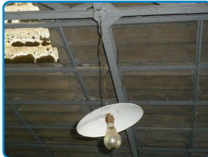
Anomalie B.3.3.6 a3 sur Install. n°1 Anomalie B.8.3 d sur Install. n°1
