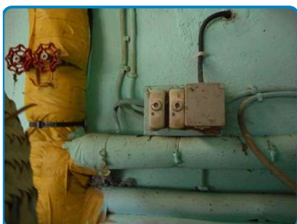
Anomalie B.7.3 e sur Install. n°1
