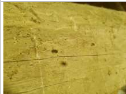
Photo n° PhTer001 Localisation : Combles - Combles Ouvrage : Charpente Parasite : Présence d'indices d'infestation d'autres agents de dégradation biologique du bois Indices : bois piqué (dégradation(s) faible(s)) Localisation sur croquis : 001
