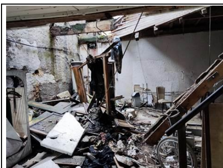
Photo n° T Ouvrage : Charpente couverture en partie effondrée + débris divers au sol
