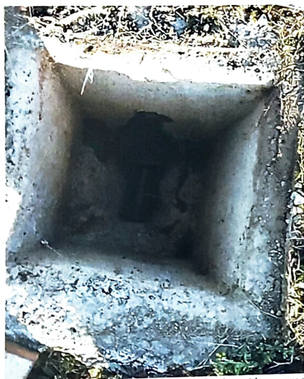
Vue sur le regard qui collecte les eaux usées traitées et les eaux pluviales
