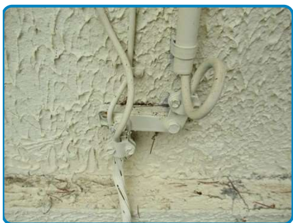
Anomalie B.3.3.1 d sur Install. n°1 (TERRE) Anomalie B.3.3.1 c sur Install. n°1 (TERRE)
