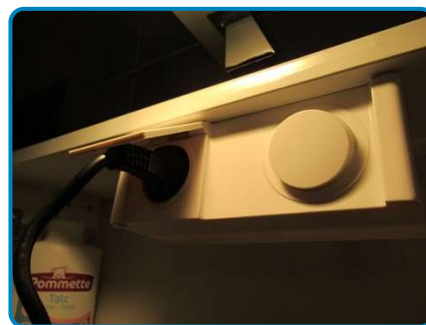
Anomalie B.5.3 a sur Install. n°1 App. n°1
