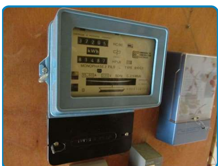
COMPTEUR sur Install. n°1 (dans Maison principale Rez de chaussée Chambre 2)
