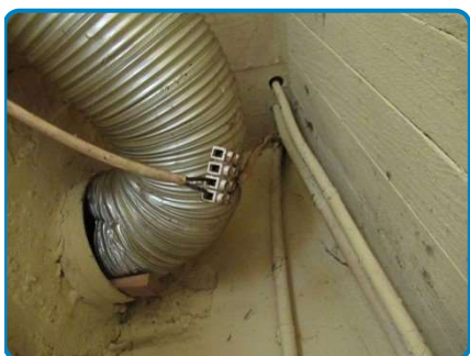
Anomalie B.7.3 d sur Install. n°1
