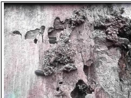
Photo n° PhTer001 Localisation : Parties extérieures Ouvrage : Sol - Végétation Parasite : Présence d'indices d'infestation de termites Indices : altérations dans le bois (dégradation(s) importante(s))
