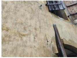
Fissures murs extérieur
