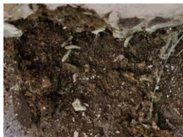
Présence de trace d'infestation de termites
