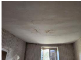
Présence de fuites d'eau au niveau de la toiture (présence de micro fissure du plâtre au plafond)
