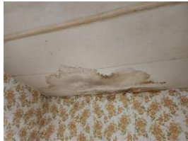
Présence de fuites d'eau au niveau de la toiture
