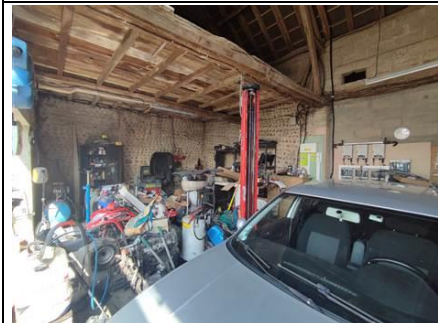
Photo n° encombrement
