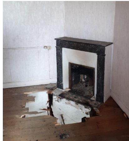
Radiateur gaz retiré suite à début d'incendie
