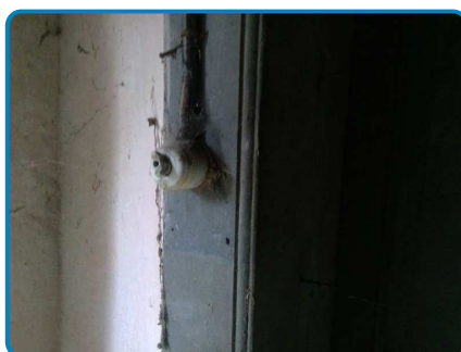
Anomalie B.8.3 a sur Install. n°1
