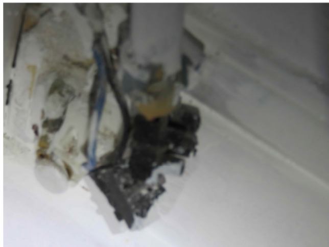
Connexion non protégé chambre 2
