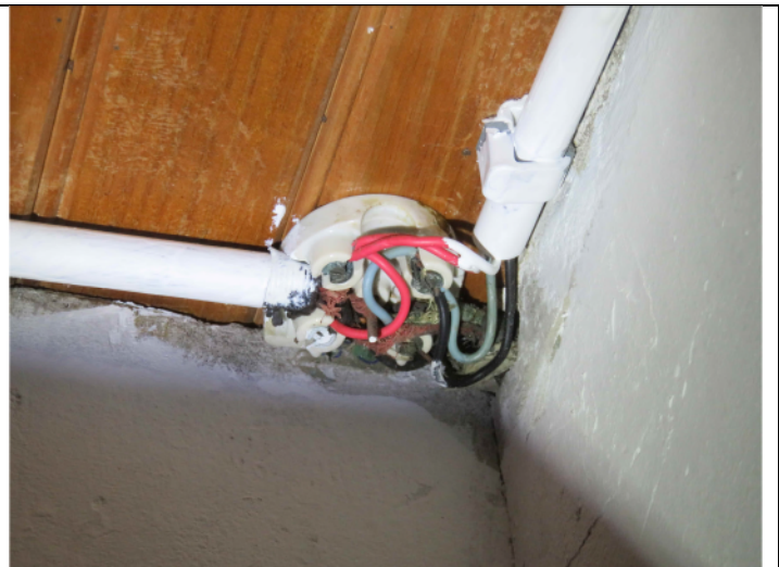
Connexion non protégé chambre 2
