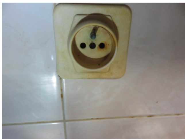
Prise avec trace échauffement cuisine
