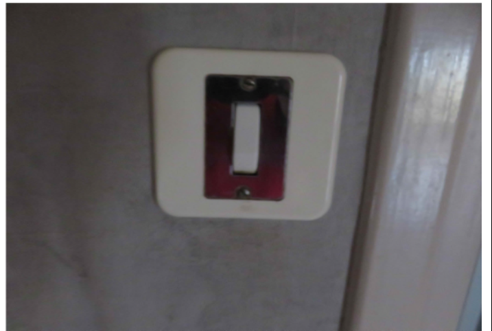
Interrupteur avec façade métallique
