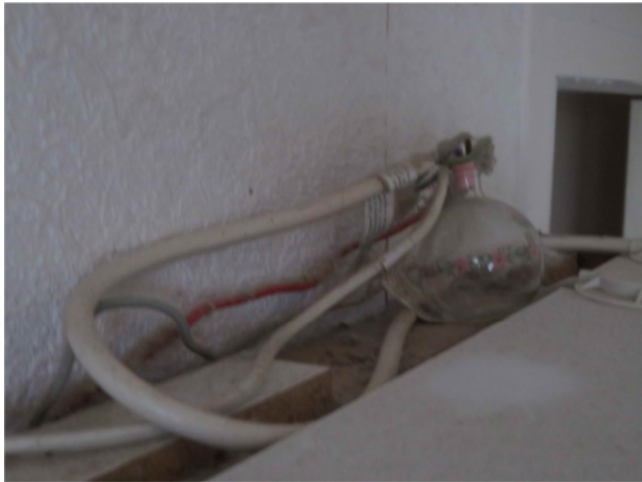
Conducteurs non protégés luminaire salle de bain
