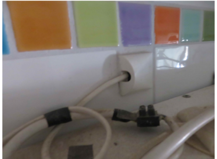
Connexion non protégé salle de bains 1
