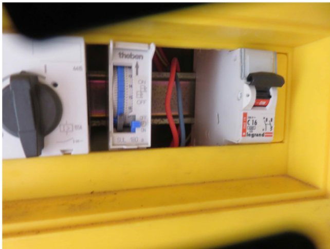
Absence de cache tableau local technique piscine
