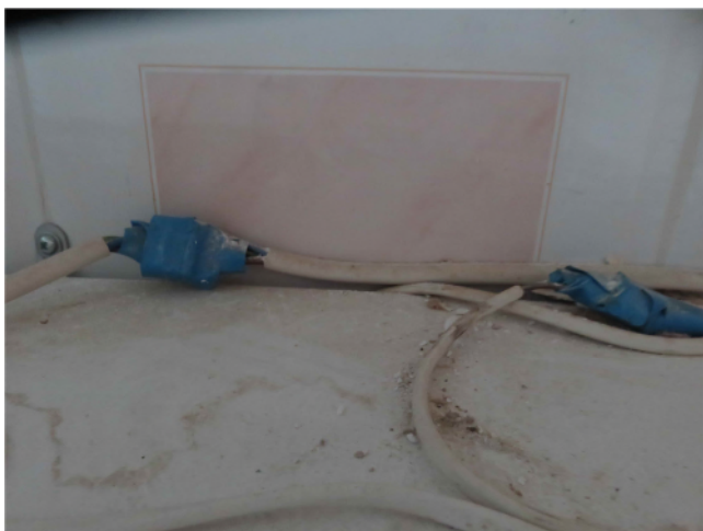
Connexion non protégé salle de bains 2
