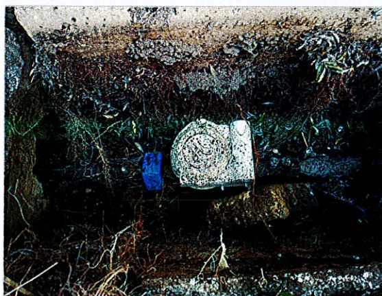
Compteur d'eau potable
