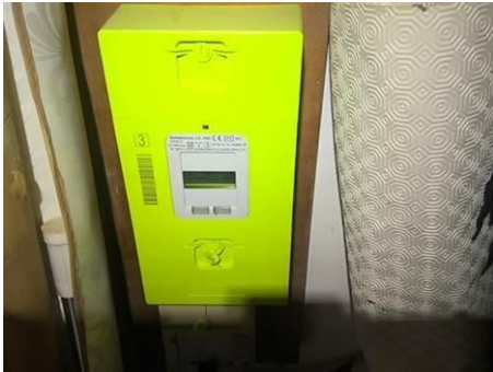
Photo du Compteur électrique
