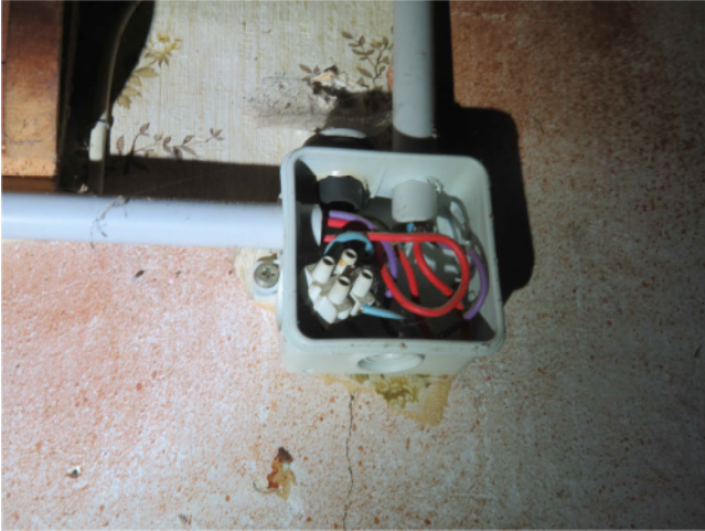
Absence de cache boîtier chambre
