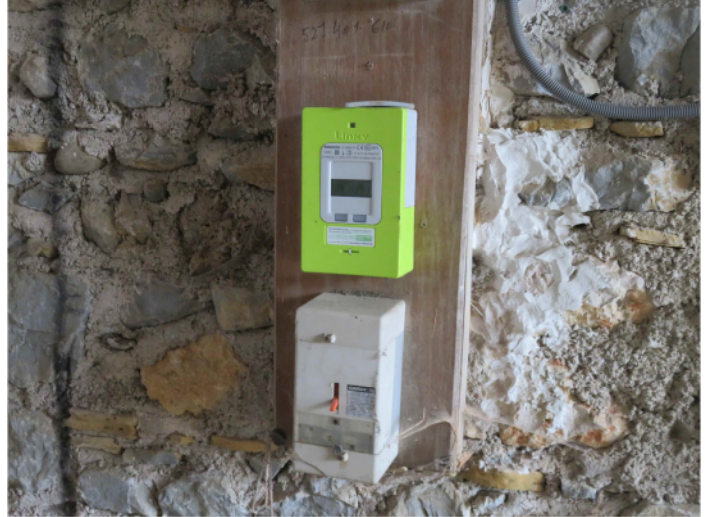
Compteur et disjoncteur garage
