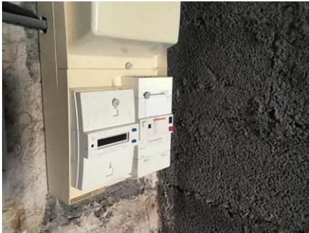
Photo du Compteur électrique
